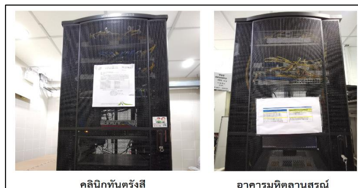
ภาพที่ 14 ตู้ Rack Server ที่ติดตั้ง ณ คลินิกทันตรังสี และอาคารมหิตลานุสรณ์
